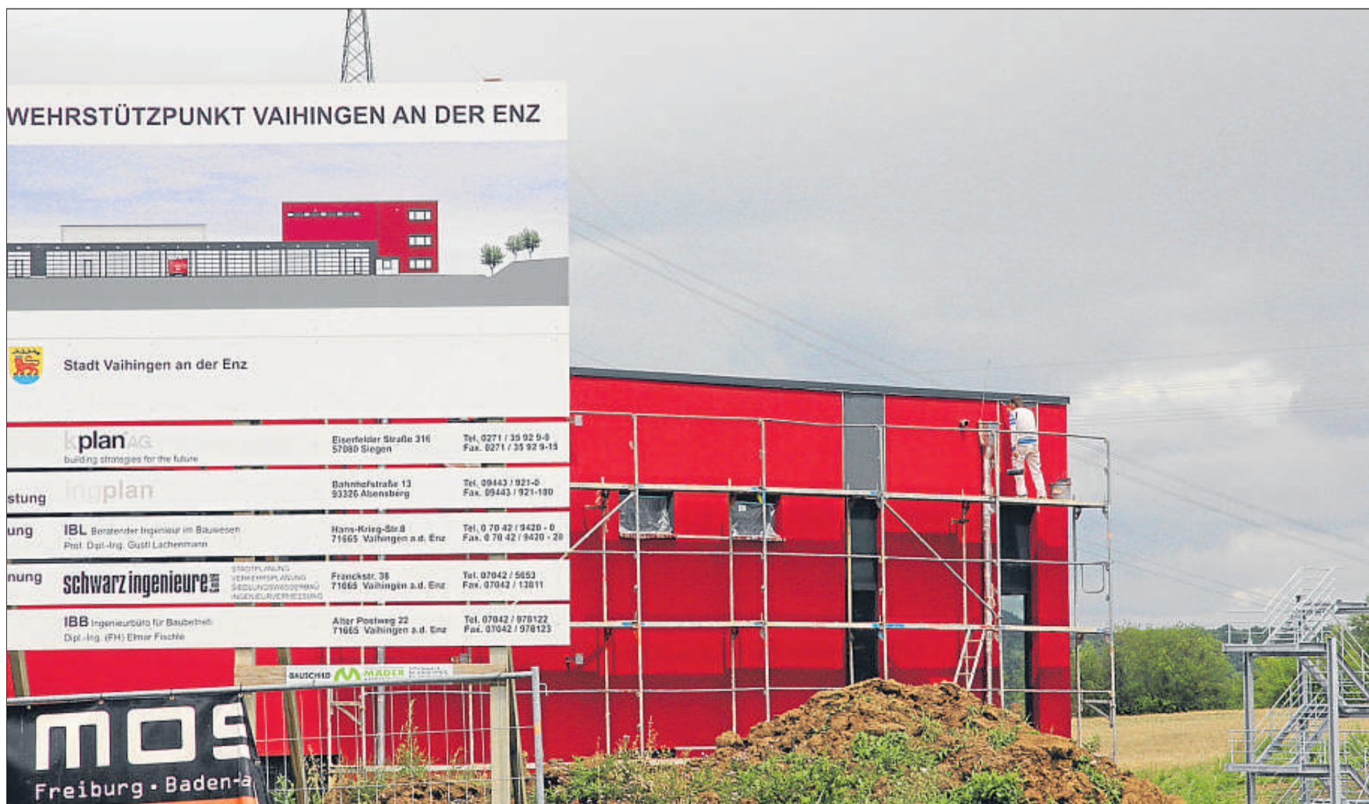
Noch ein Versuch, eine ebene Putzfläche auf dem Vaihinger Feuerwehrhaus anzubringen.
